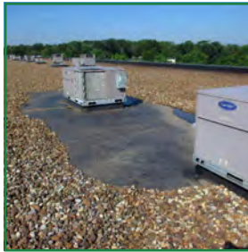
Uneven Ballast Gravel
